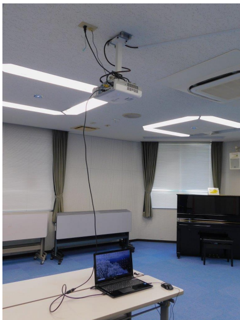
図-10 天井吊下げプロジェクターと真下に置いたパソコンを HDMI ケーブル(2.6m)で接続した状態
