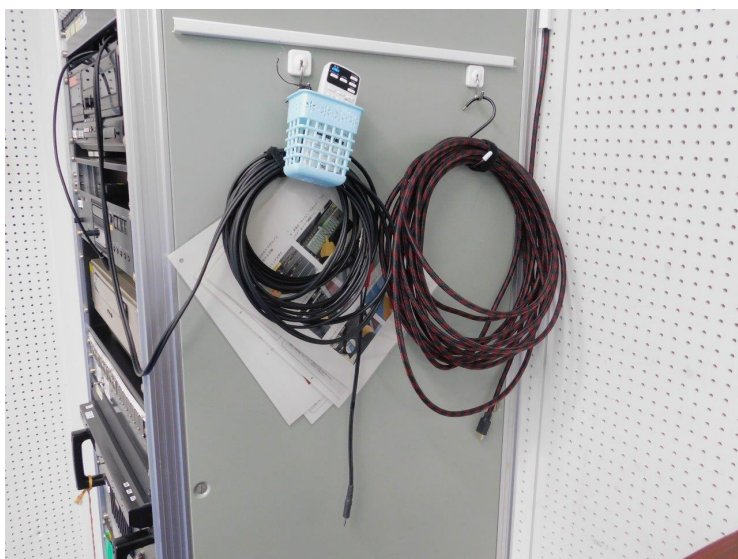
図-3 音響ラックの側面の拡大写真
