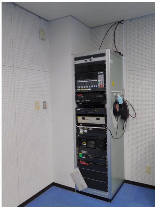
図-1 音響ラックの全体写真
